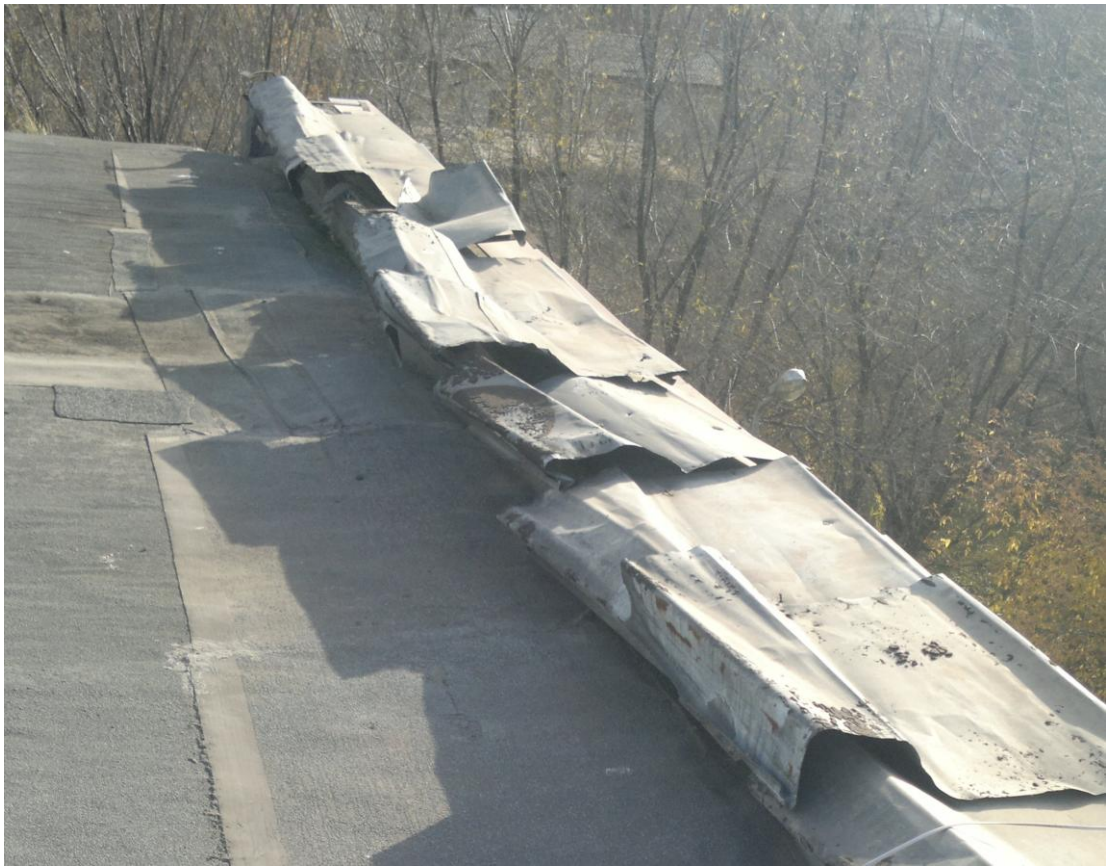
Фото 9. Сильно деформированы стальные защитные фартуки.
