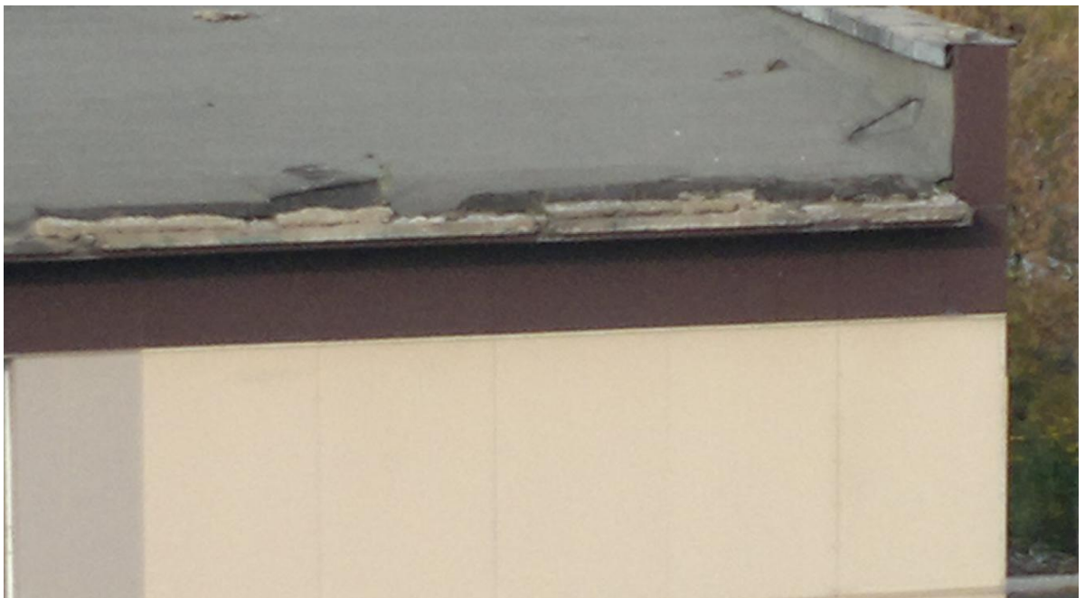
Фото 10. Разрушение рулонного ковра в карнизной части.
