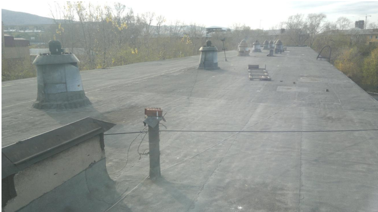
Фото 7. Отсутствуют защитные колпаки над отдельными вентиляционными установками.
