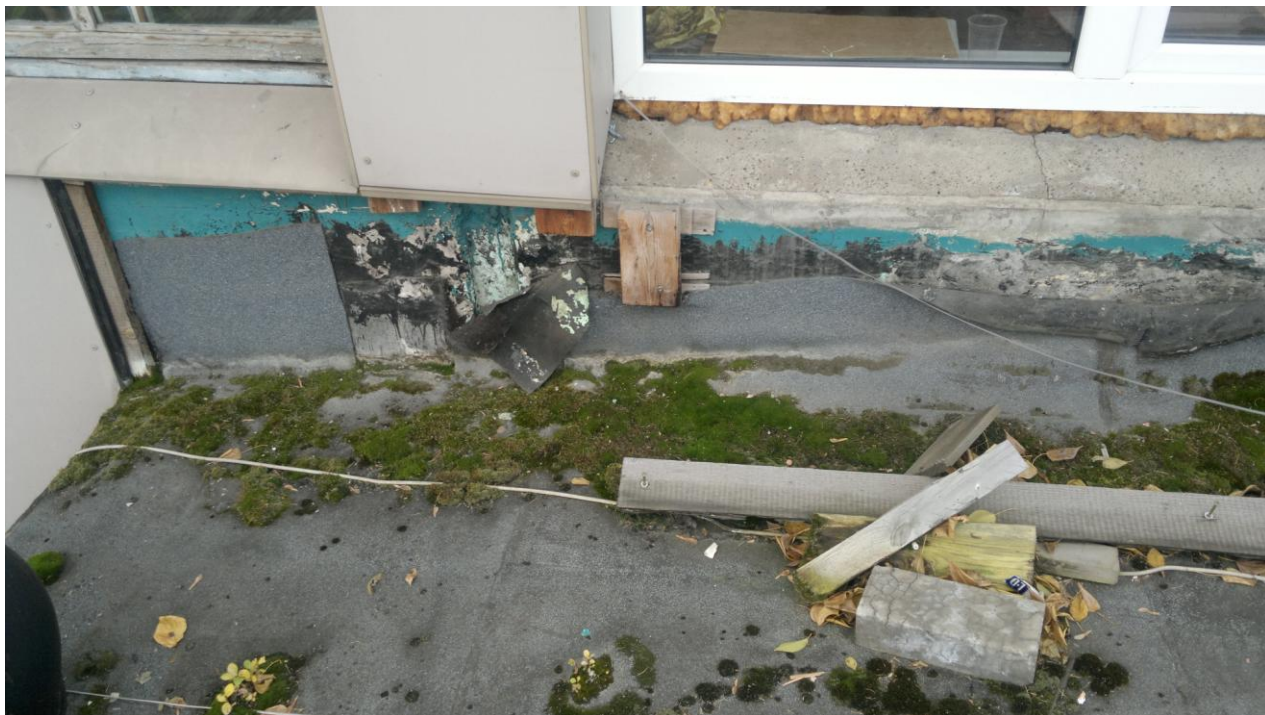
Фото 3. Поросли мха, негерметичное примыкание рулонного ковра к стене здания в осях 3/Е-И.
