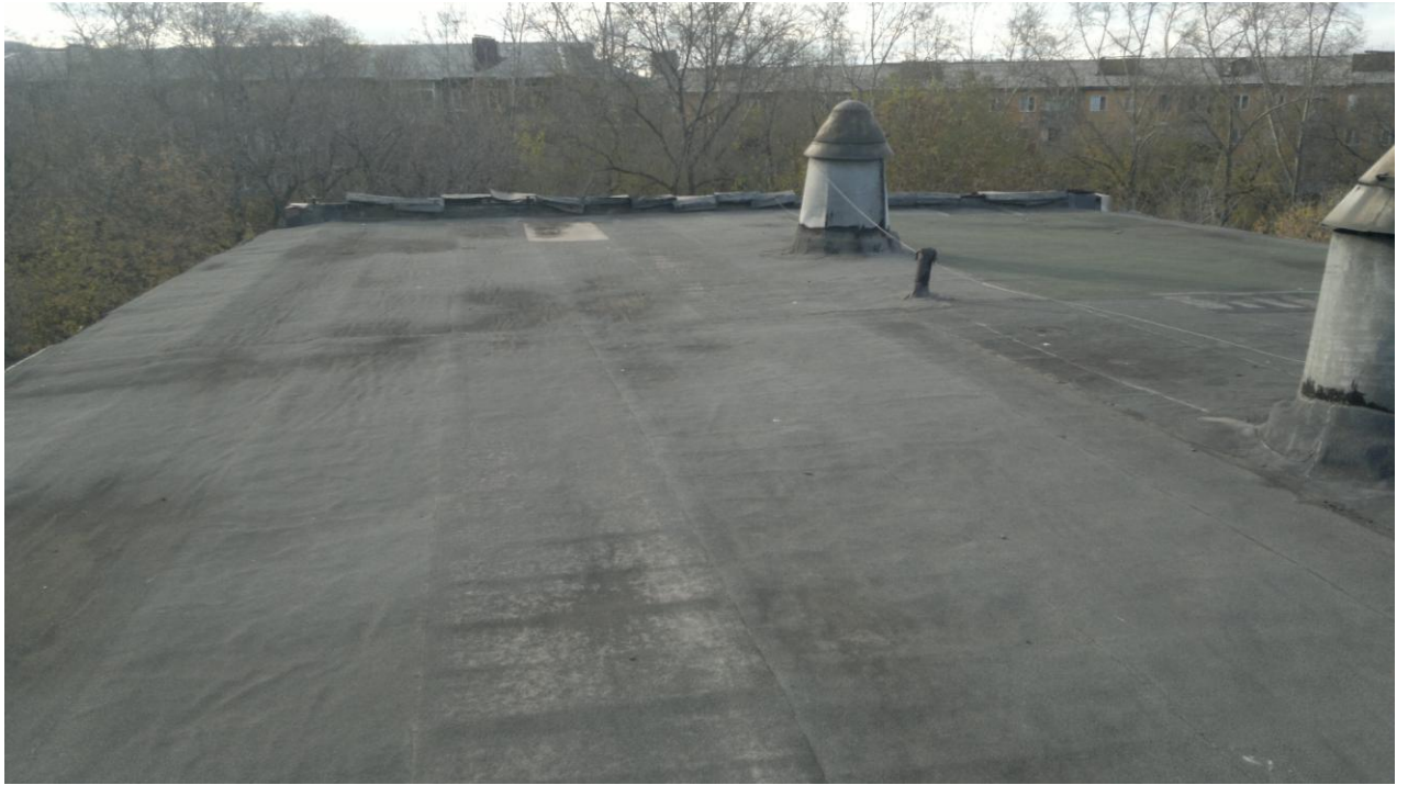
Фото 1. Многочисленные следы застоя атмосферных вод, провалов стяжки.
