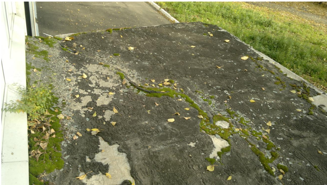
Фото 15. Полное разрушение рулонного ковра кровли козырька по оси 1.
