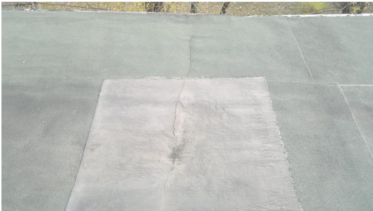
Фото 5. Разрыв, следы ремонта рулонного ковра.
