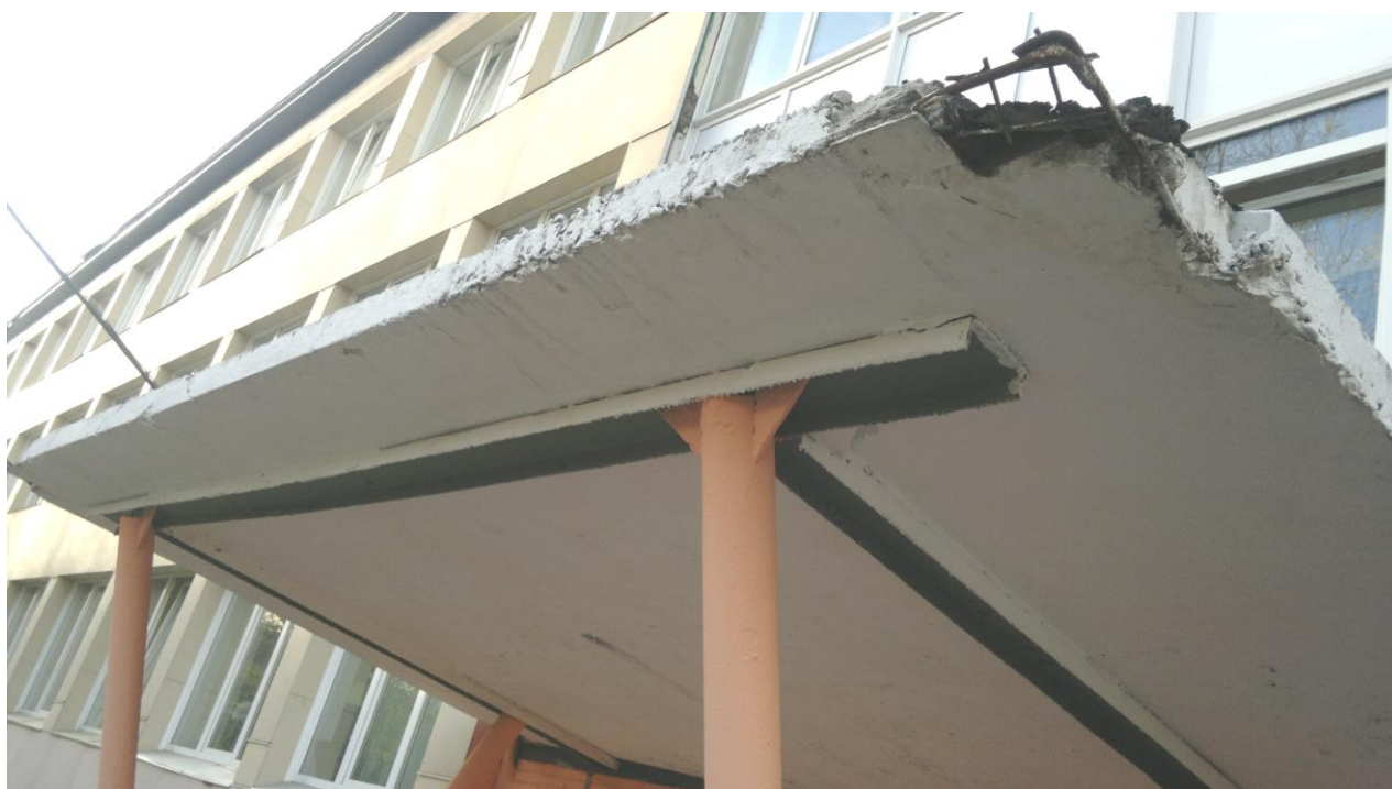
Фото 16. Разрушение защитного слоя бетона козырька по оси 1.
