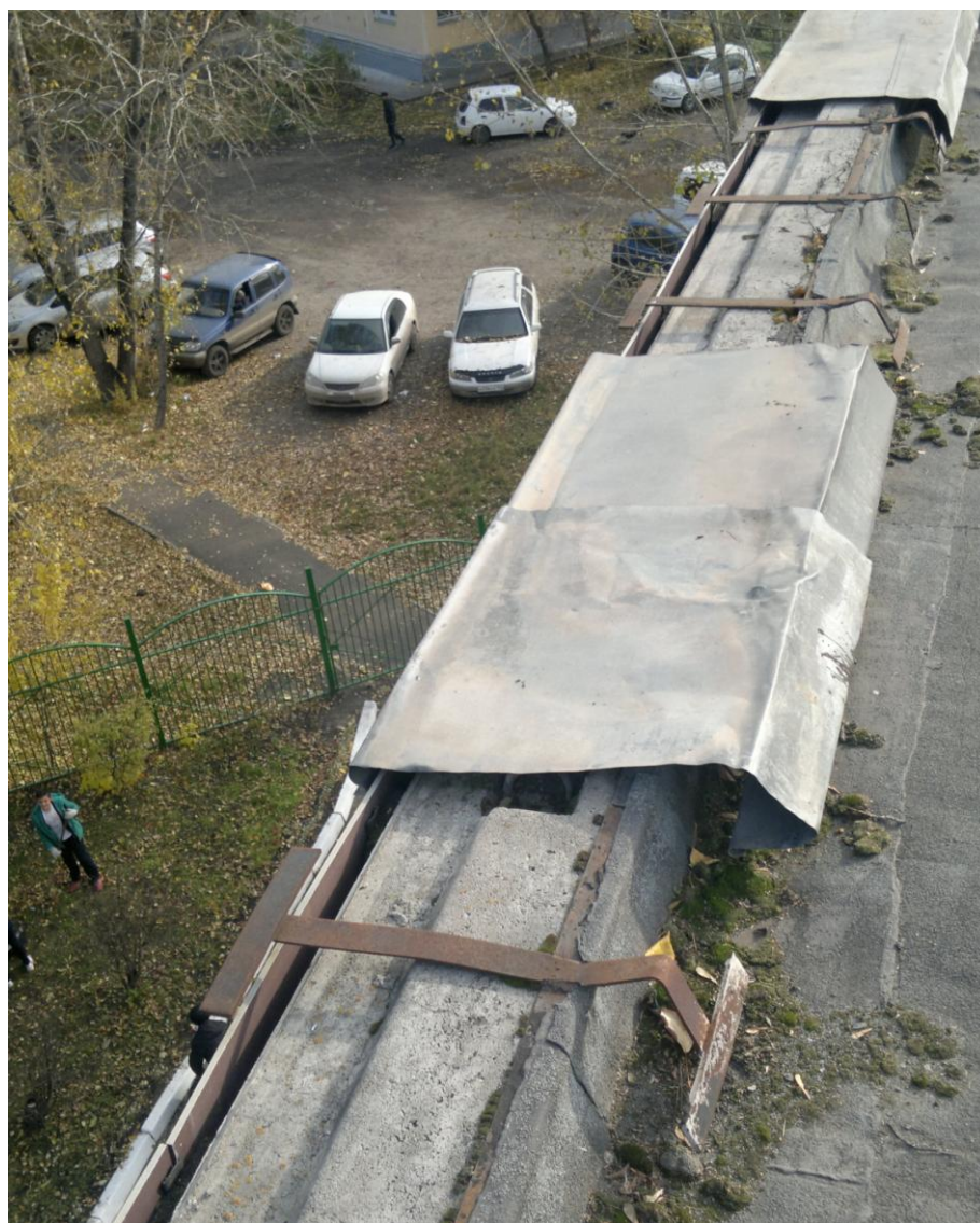
Фото 8. Отсутствуют стальные защитные фартуки, деформированы стальные детали крепления фартуков к парапетам.
