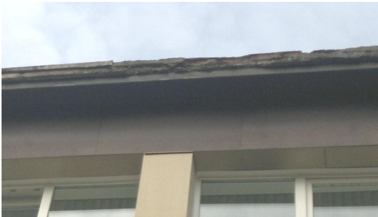
Фото 11. Морозное разрушение защитного слоя бетона карнизных плит.
