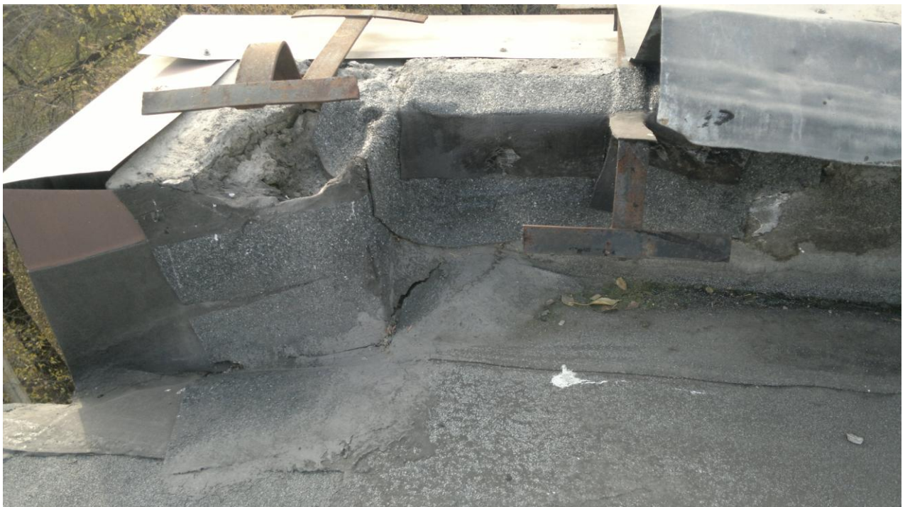
Фото 2. Негерметичное примыкание рулонного ковра к парапету, разрыв ковра, отсутствие защитного фартука, деформированы стальные детали крепления фартуков к парапету.
