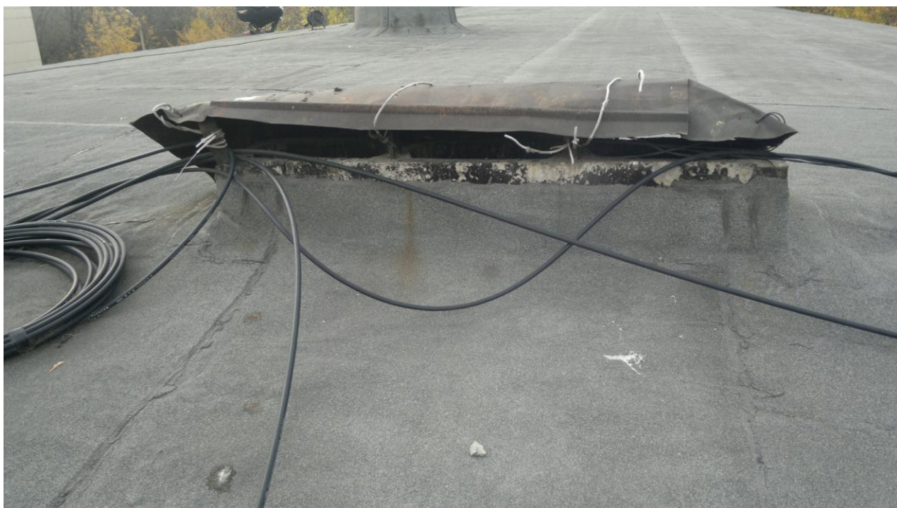
Фото 6. Зонт вентиля деформирован, выпуск шахты выведен на 0,13м за пределы кровли.
