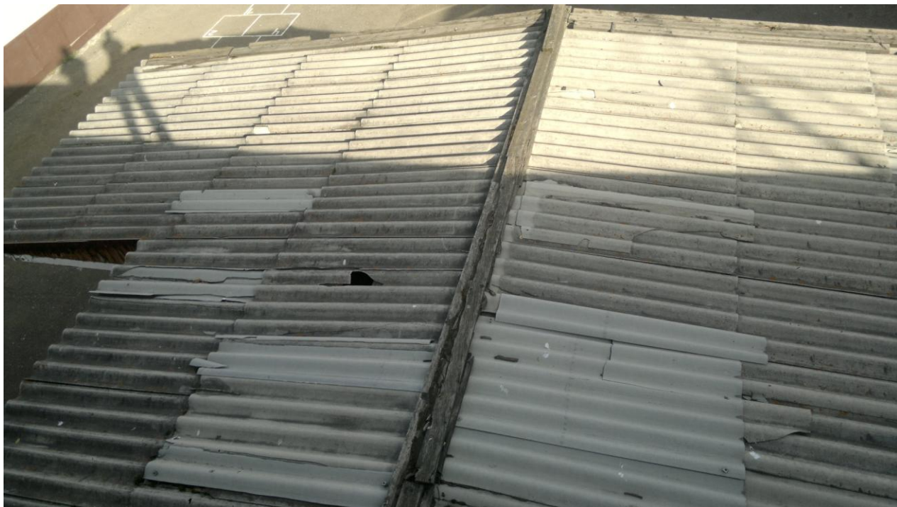
Фото 17. сколы, трещины, значительный физический износ волнистых асбестоцементных листов кровли козырька по оси Е.
