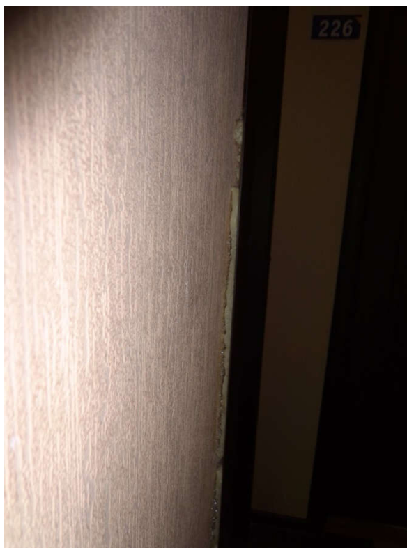
№228 монтажная пена под наличником дверного блока
