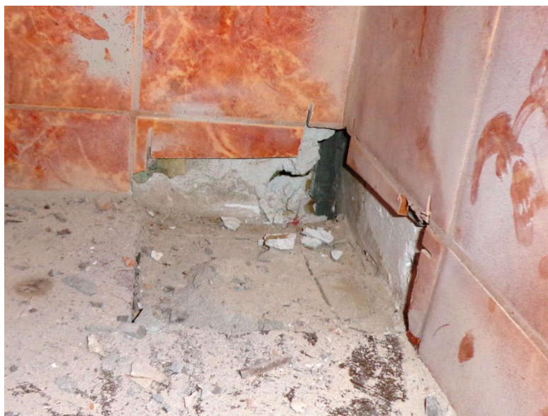
№ 328 отсутствие гидроизоляции, замачивание и разрушение стен
