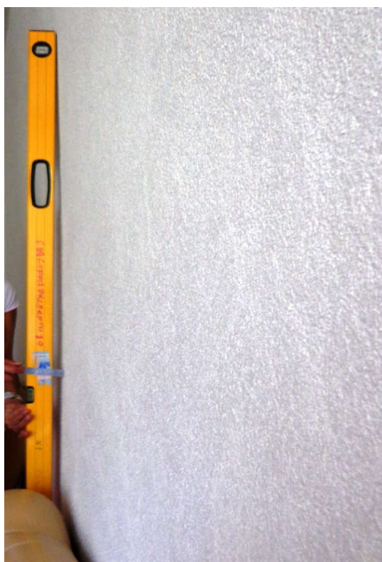
№312 отклонение поверхности стен
