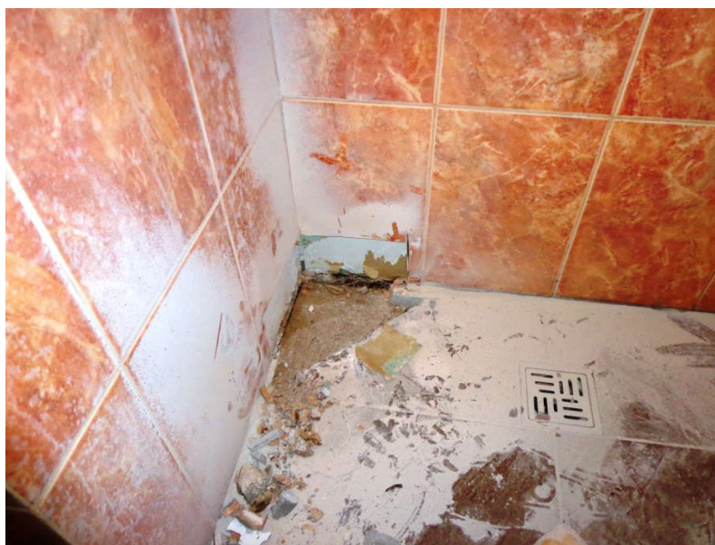
№212 отсутствие гидроизоляции, замачивание и разрушение стен
