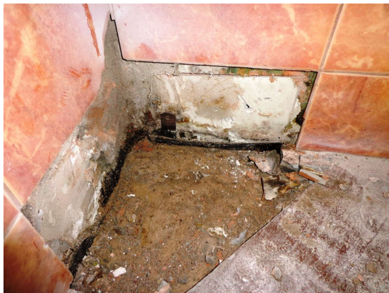
№138-140 отсутствие гидроизоляции, замачивание и разрушение стен
