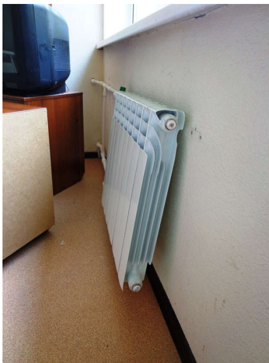
№322 некачественная установка радиатора
